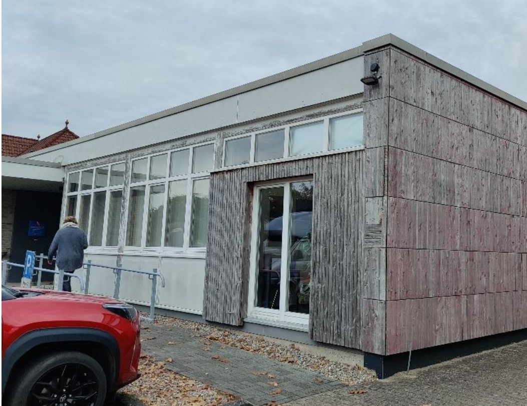
Foto 4: An Flachdachgebäuden, wie z.B. einem Gebäude nördlich des Rathauses (s. Foto) sowie auch an vielen Garagenanbauten befinden sich umlaufende Metallabschlussleisten.
